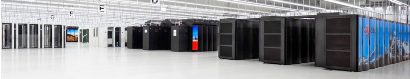
Übersicht des Maschinenraumes. (Bild: CSCS)
