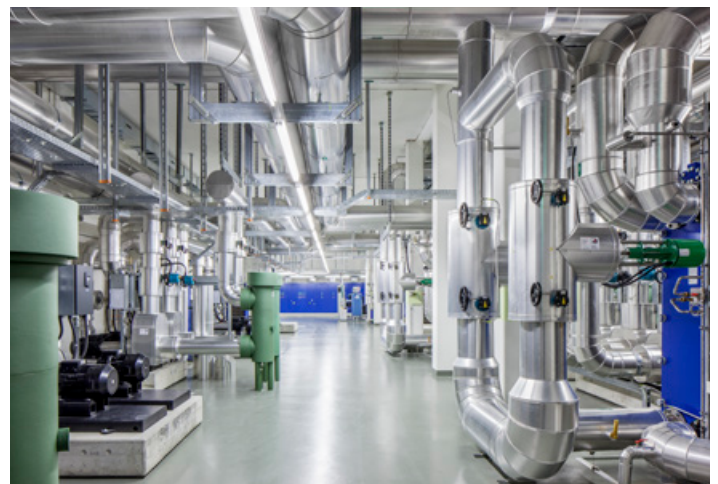
Die Fotos zeigen die drei Stockwerke des Rechnergebäudes. Von unten nach oben: Ressourcendeck, Installationsstockwerk und Maschinenraum. (Bild: Marco Carocari und CSCS)
