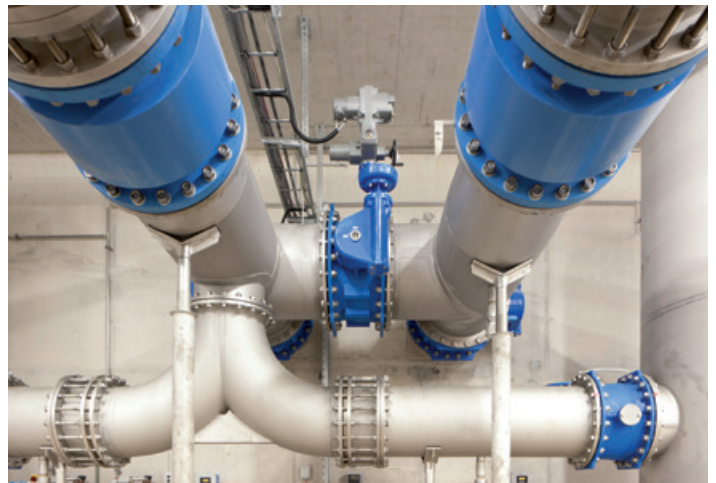
Im Labyrinth der Pumpstation: Fünf Meter unter dem Rasen des Parco Ciani fördern Pumpen über 700 Liter Wasser pro Sekunde aus dem Luganer See. (Bild: Marco Carocari)
